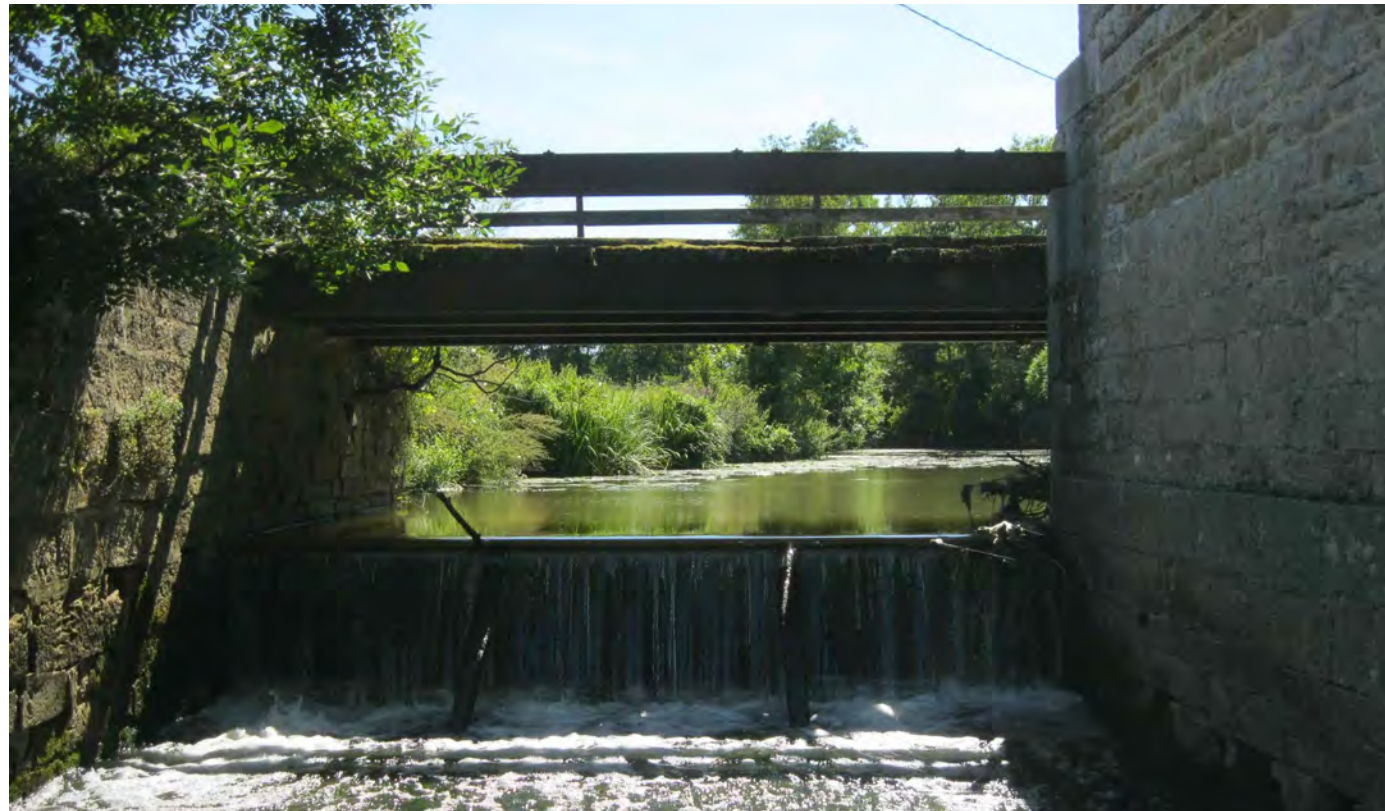
Exemple de seuil : Moulin de la Chanée sur le Sevron (source : EPTB Saône-Doubs)
