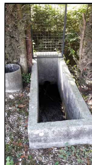
Rejet des eaux
