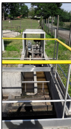
Dégrilleur / dessableur / déshuileur
