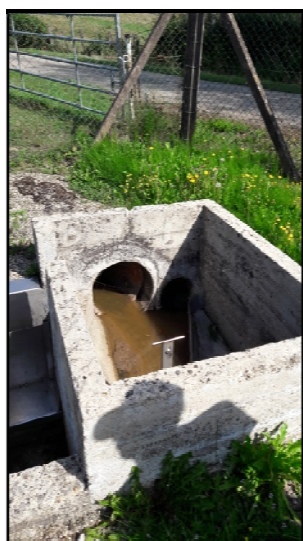
Arrivée du réseau
